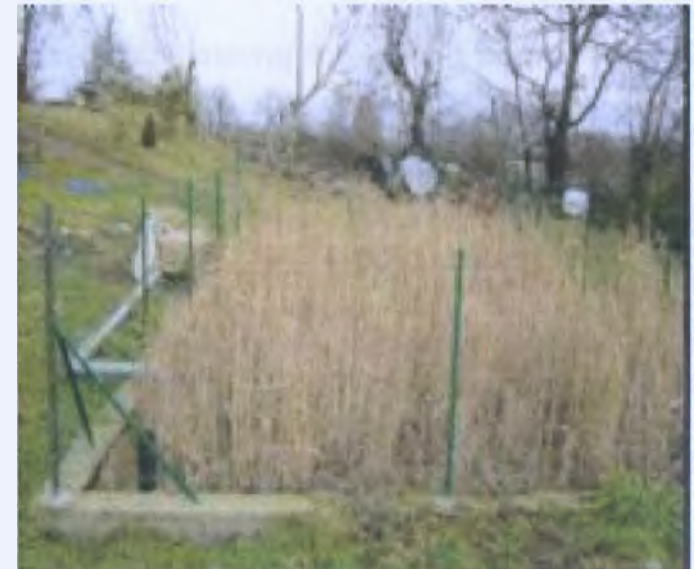
Assainissement avec filtre à roseaux
